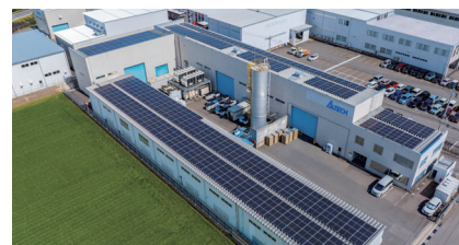
アルテック新材料 福井工場 (243kWの発電設備)
